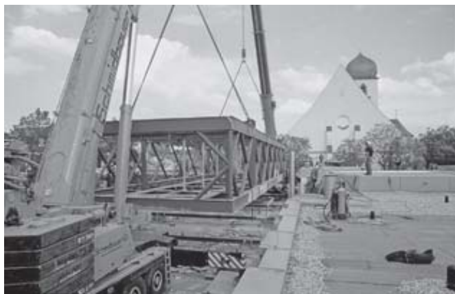
Die Erweiterung des Kindergartens Leiden Christi geht nach langwierigen Schwierigkeiten in der Planung nun langsam ihrem Ende entgegen. Auf großes Interesse stieß die Aufstellung des Stahlgerüsts, das die Tragstruktur der Aufstockung darstellt und das am 12. Mai 2006 mit Hilfe von zwei Autokränen auf den bestehenden Kindergarten gehoben wurde.
